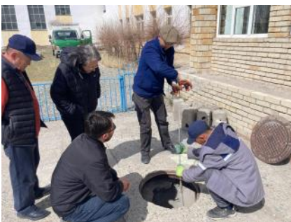
Die Sondierung mit einer Stahlru- te bestätigte unseren Verdacht: Die Wurzeln der Büsche (Im Bild hinten) hatten den Weg in die Abwasserleitung gefunden.
